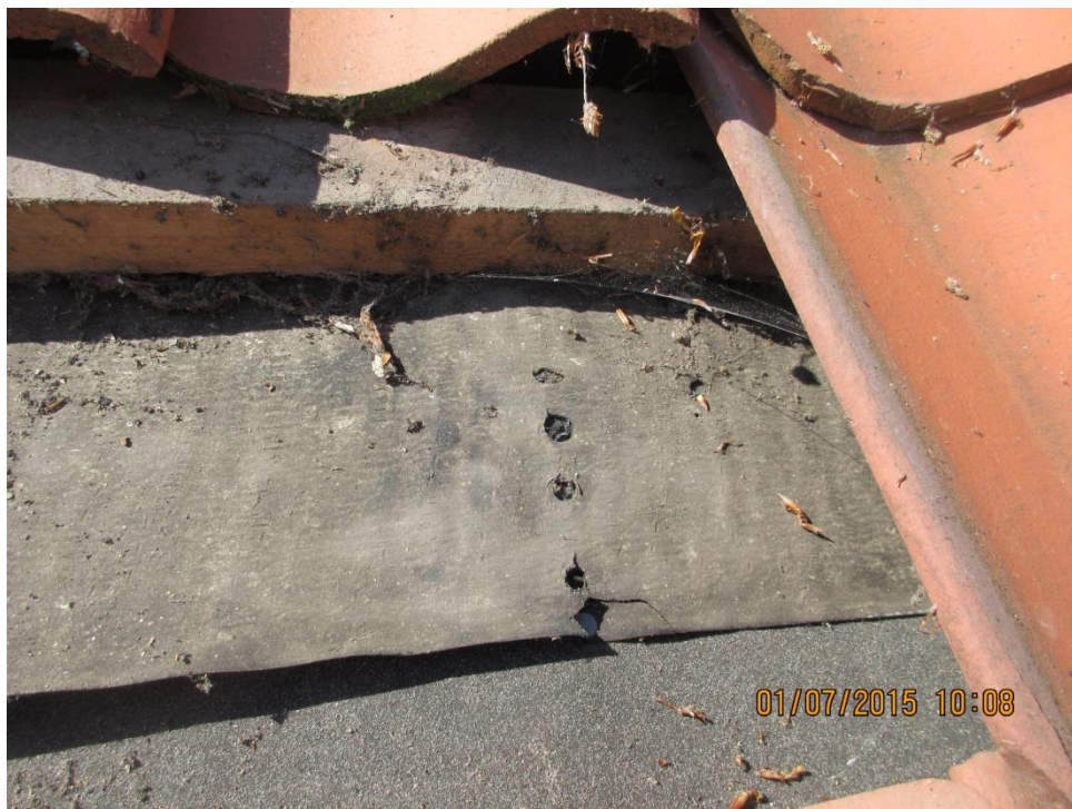
Foto 02: Der er ikke monteret 25 mm afstandslister på spærhoved på overside undertag under lægter.
