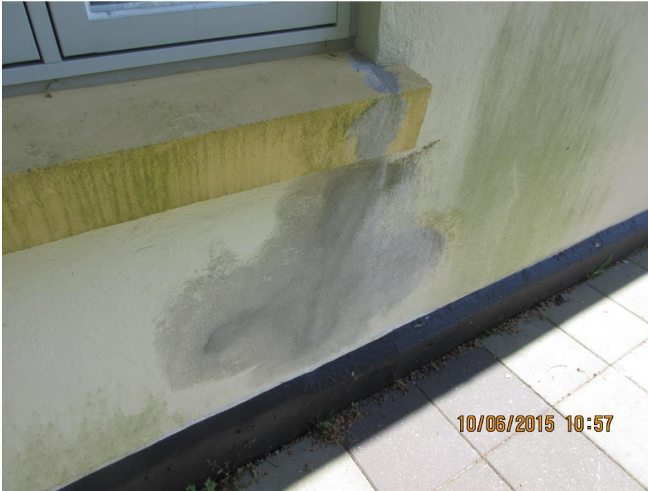
Foto 09: Foretagne pudsreparationer er generelt foretaget i cementholdigt mørtel.
