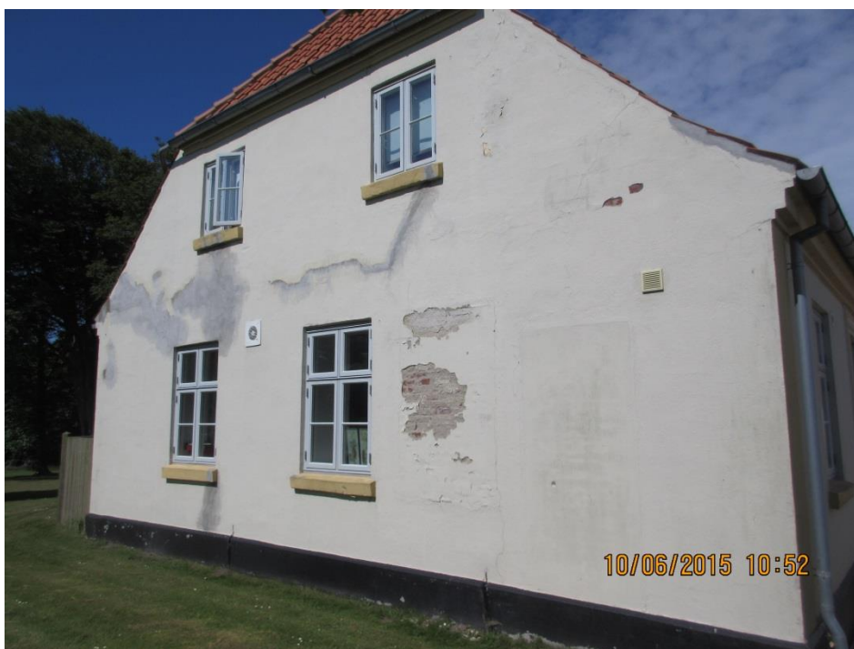
Foto 07: Gavl mod øst i særdeles dårlig stand med afskalninger og udførte pudsreparationer.
