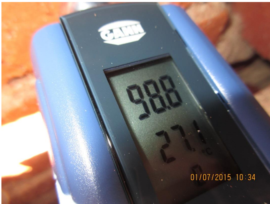
Foto 13: Med GANN blev der målt fugt i bagmur på ca. 99 digits, hvilket indikerer decideret vådt murværk.
