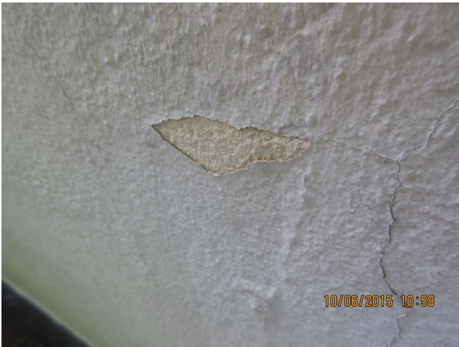
Foto 10: Et af malingslagene er udført med plastikmaling, som skaller.
