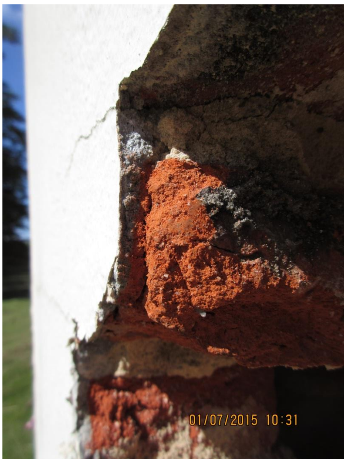
Foto 12: Fotoet viser plastmaling på facaden samt cementholdigt puds på facaden.
